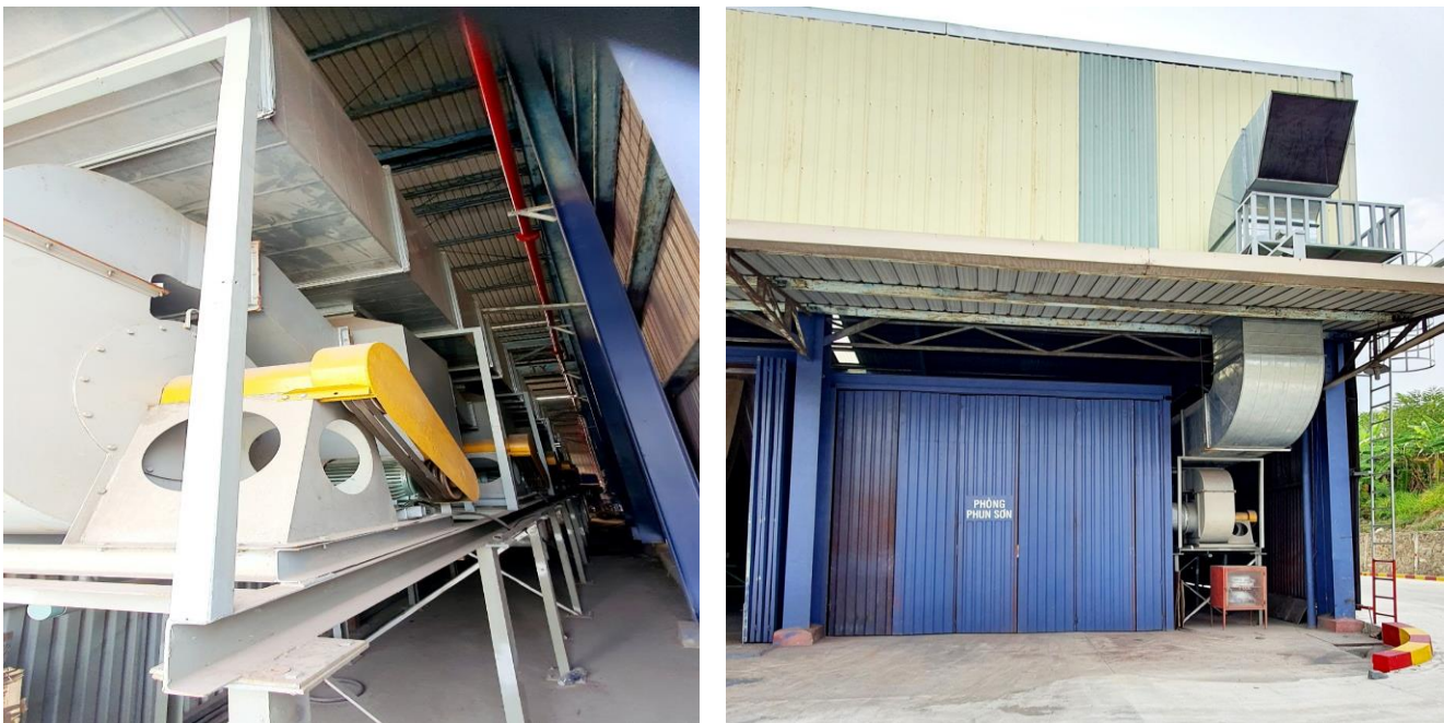
Hình 3.10. Hình ảnh hệ thống thu gom xử lý bụi, hơi dung môi từ công đoạn sơn
